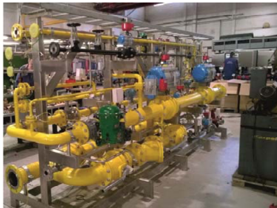
Maakaasun venttiiliasema. Toimitettu Slovakiaan 2014
